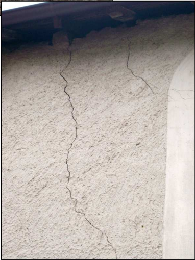
FISSURATION DES MACONNERIES AU DROIT DES FERMES
