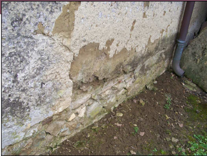
DESCENTE EP NON RACCORDEE (FACADE NORD)
